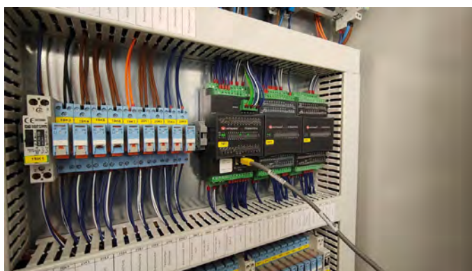
Schaltschrank mit SPS und ComatReleco Produkten.
