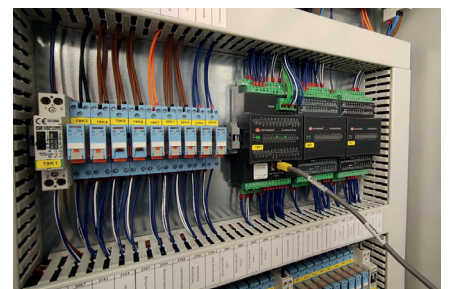
Schaltschrank mit SPS und ComatReleco Produkten.
